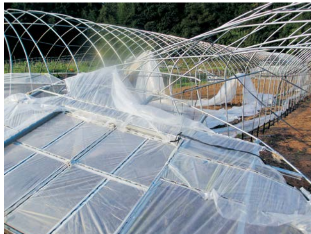
台風による施設の倒壊
