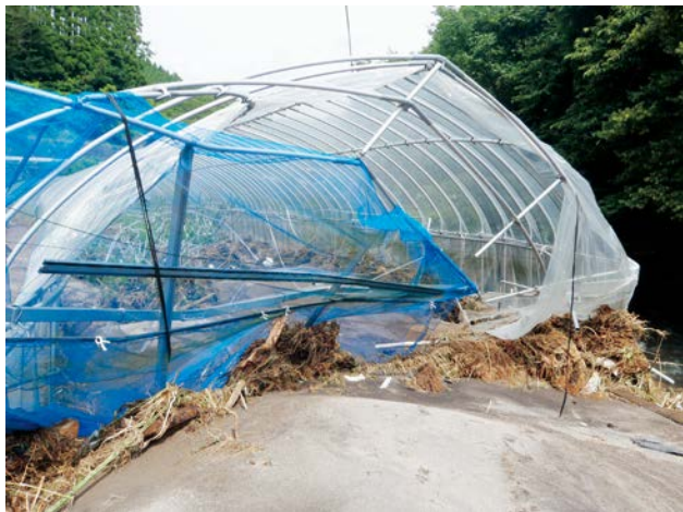
水害による土砂流入
