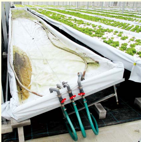
大雨により、栽培ベッドが倒壊した
