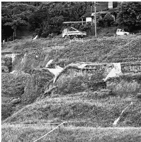
綿田地区の被害の様子
