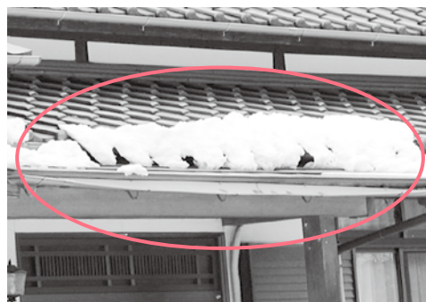
降雪による被害では、写真のように雨樋(あまどい)が曲がる、破損するなどの被害が多くみられました。
